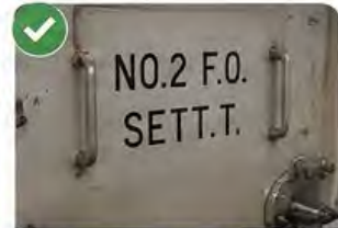
IDENTIFICACIÓN CLARA DE TANQUES Y SISTEMAS
