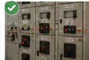
SUMINISTRO ELÉCTRICO ADECUADO Y PROTEGIDO
