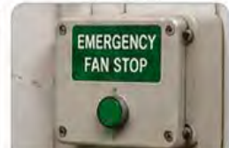
PARADA DE VENTILADORES DE EMERGENCIA
