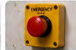
PARADAS DE EMERGENCIA
