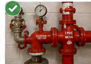
VÁLVULAS DE FIRE MAIN, BOMBA Y SEA CHEST CLARAMENTE MARCADAS
