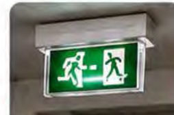
ILUMINACIÓN DE EMERGENCIA
